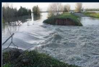
Exemple de rupture de digue Cru du Rhône 09/2003
